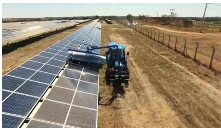
Imagem 13 - Exemplo de limpeza dos módulos fotovoltaicos
